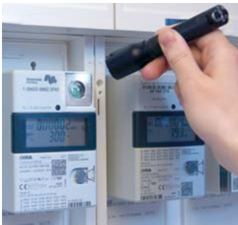
Falls Sie verschiedene Tarife oder eine Eigen-erzeugungsanlage haben, können Sie hier weitere gespeicherte Verbrauchswerte ablesen. Ansonsten erscheinen hier keine Menüpunkte.
